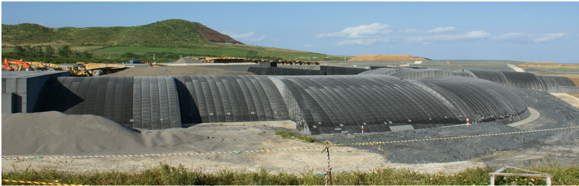
【写真】滑走路直下の洞窟の陥没を防ぐためにつくられたアーチ状構造物だが・・・
